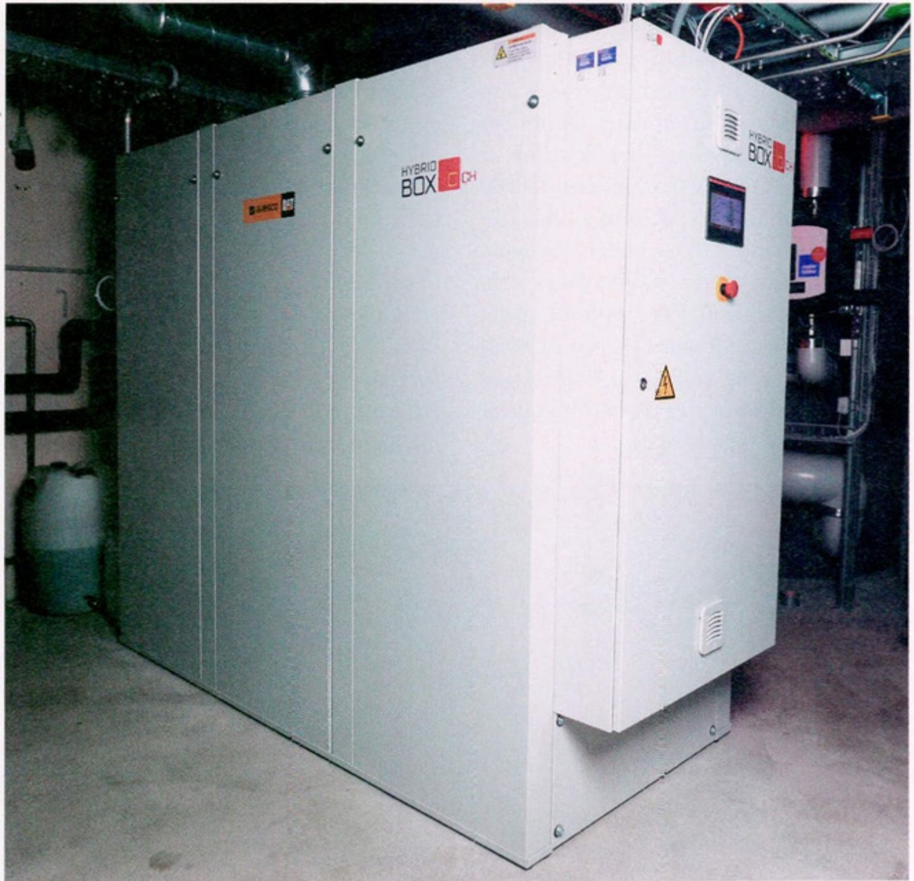
Zentraler Baustein der Energieversorgung: Im Heizungskeller steht eine Hybridbox, die für den Betrieb mit Methanol umgerüstet wurde.
